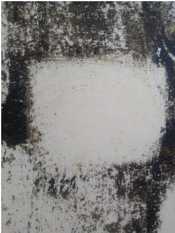
Abb. 45: Nahansicht gereinigte Fläche auf der Stahlplatte, November 2019
